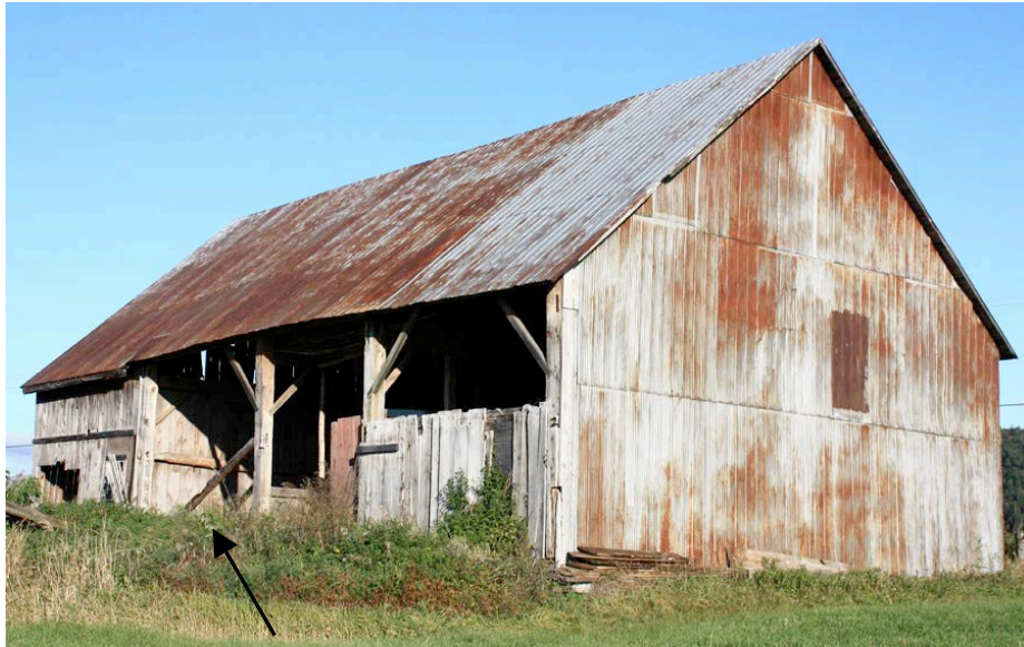
Grange-étable passablement détériorée, rue Principale à Fassett. La structure est instable, un billot a même été placé afin de solidifier un poteau. D'autres bâtiments secondaires de la MRC sont dans le même état.
