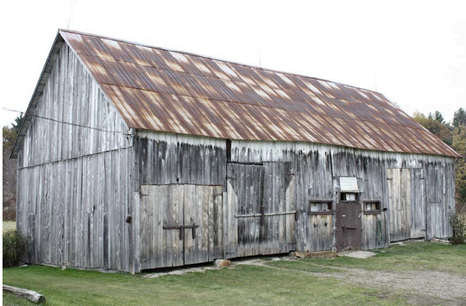
Le revêtement de la toiture de cette grange-étable est fortement détérioré, tout comme la façade. Montée Saint-François, Plaisance.
