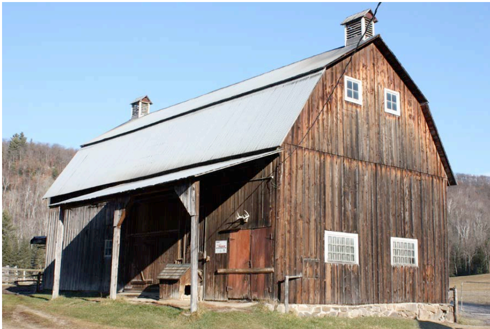
Un des rares bâtiments secondaires se démarquant par la qualité de son état physique et de son état d'authenticité. Grange-étable au 7517, route 315 à Mulgrave-et-Derry.
